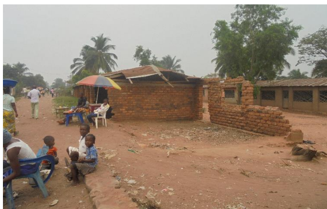
L'état de l'école en 2017 après une pluie torrentielle
